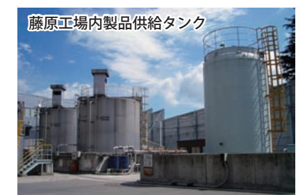
出荷製品は製品供給タンクへ一時貯蔵
